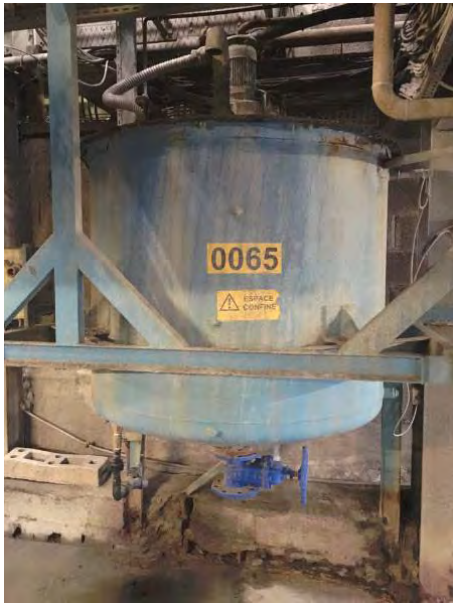
Cuves réactifs flottation
